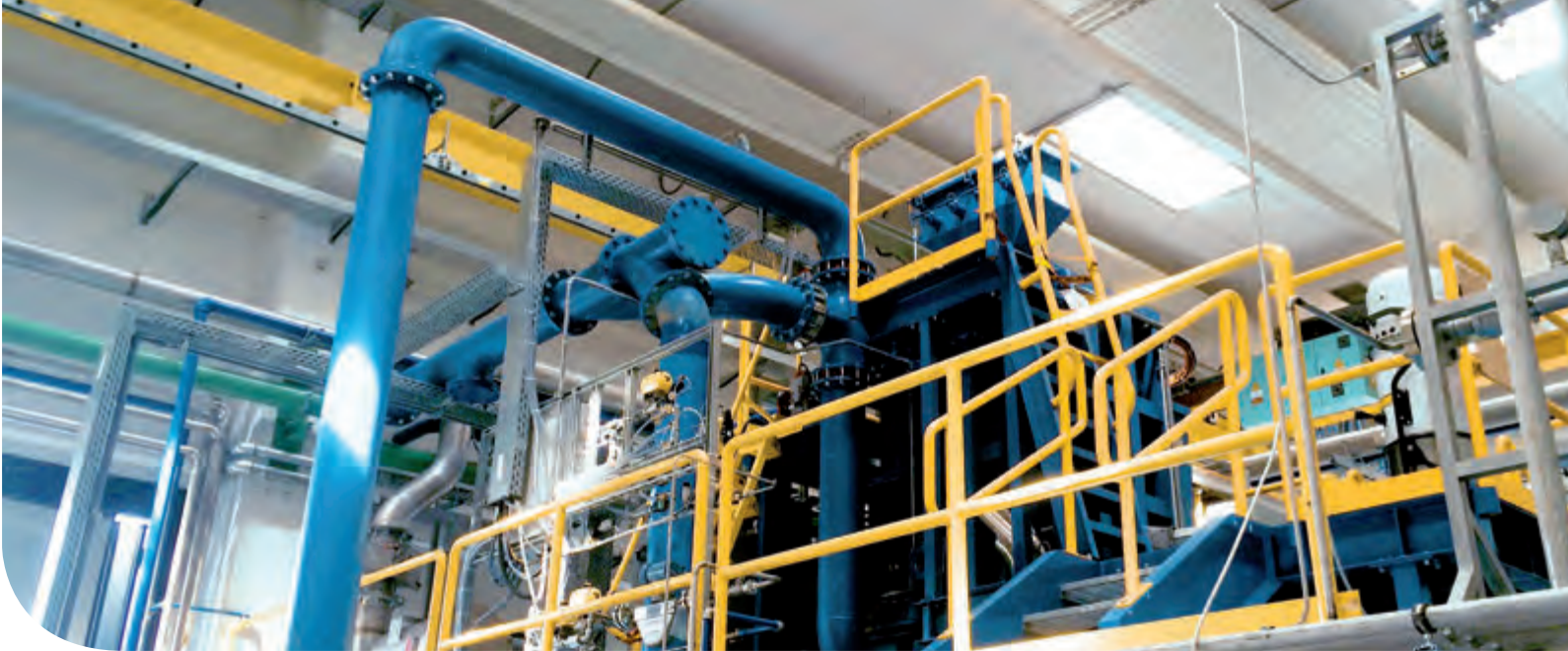
Vista della parte superiore e panoramica (foto in basso) dell'atomizzatore nel nostro stabilimento di Cameri.
